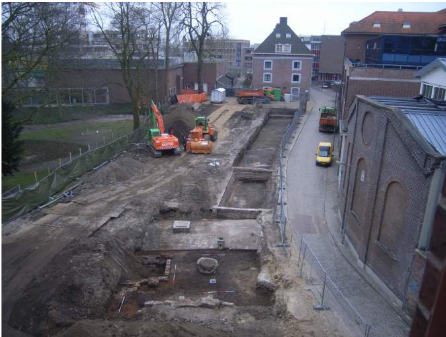
Afb. 5.1 Overzicht van de opgravingsputten naar het zuiden met op de voorgrond de overkluisde Binnendieze (het 'Hellegat').
